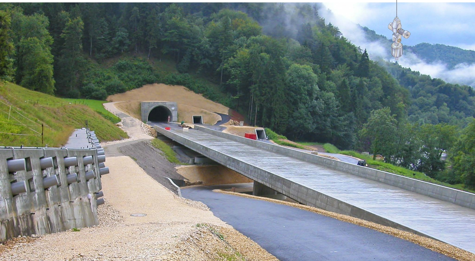
Autobahn A16 Transjurane, Neubau Streckenabschnitt Roches-Moutier, Kanton Bern: Trivec-Messungen in einer Pfahlwand
