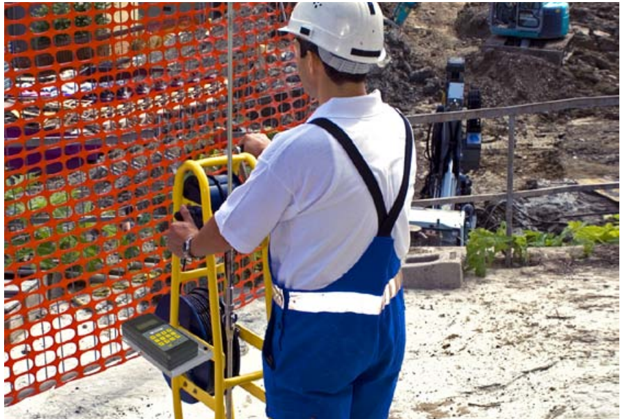
Gleitdeformeter - und Gleitmikrometermessung mit dem MRD
