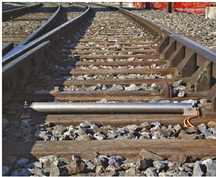
Neigungssensor auf Bahnschwelle montiert
