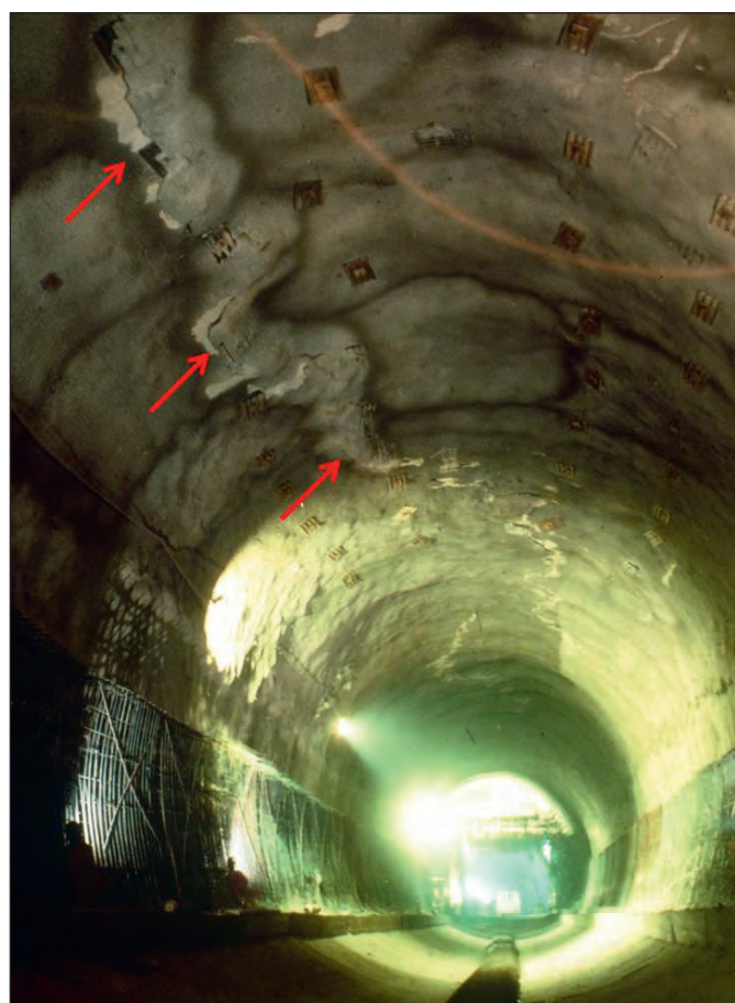
Figure 5 - Rupture brusque de la coque de béton projeté lors de l'excavation du radier du tube Nord. Le treillis soudé a été plié en Z sur une longueur d'environ 30 m (cf. flèches) / Sudden shear failure of primary concrete lining during invert excavation in the north tube.
